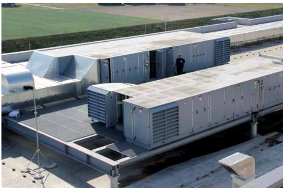
Eine der Lüftungsanlagen bei GERRY WEBER
