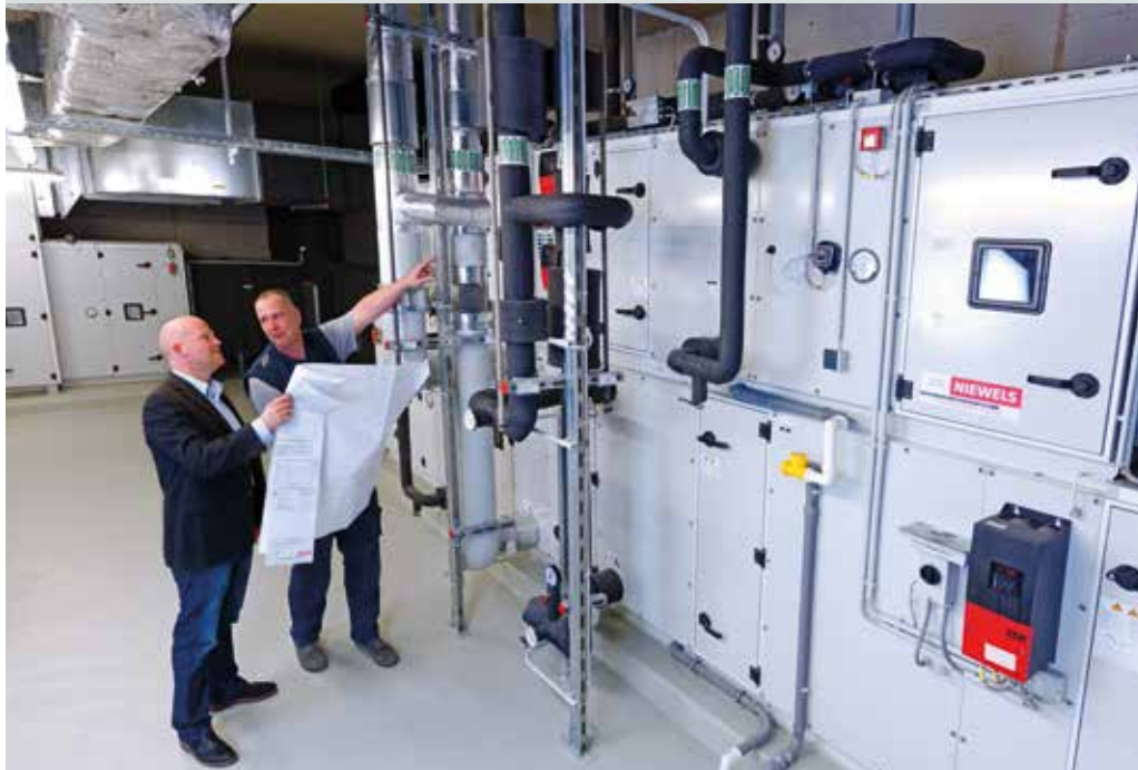
An einer der 4 neuen Lüftungsanlagen: Tobias Stake (r.), Mitarbeiter im Bereich Instandhaltung, und Christoph Niewels
