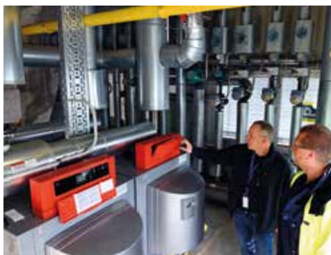
Die Kesselzentrale des heimischen Flughafens
