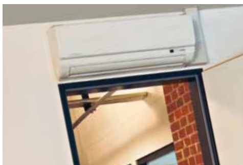
Rund 200 Geräte sorgen für ein optimales Klima.
