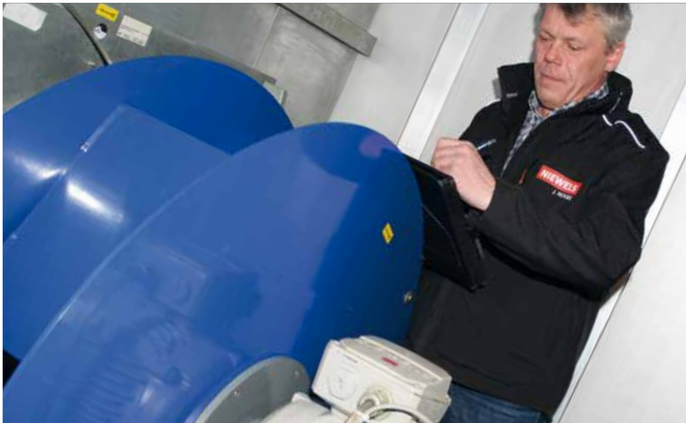
Technischer Leiter Jürgen Ressel bei der Überprüfung eines Ventilators.
