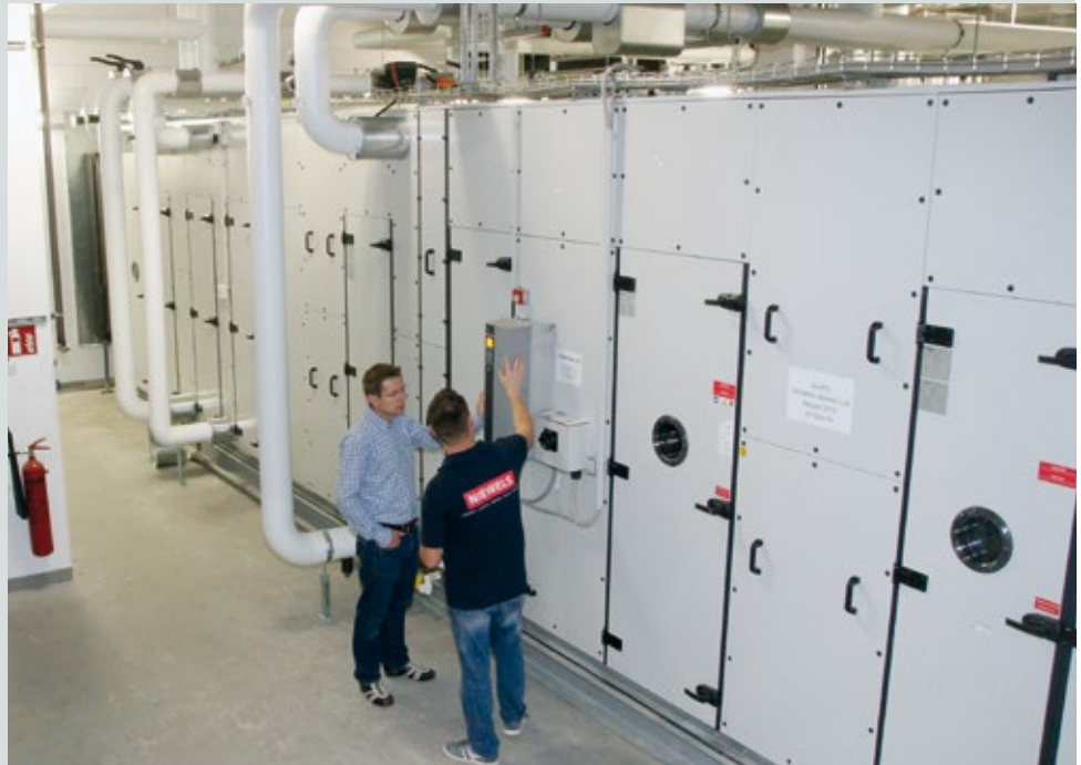
Dr. Oetker-Gruppenleiter Technischer Service Josef Gorny und NIEWELS-Projektleiter Olaf Striewe an der Lüftungsanlage in der Technikzentrale.
