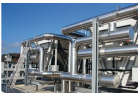
Der Hybrid-Kühler der ALMO-Energiezentrale.
