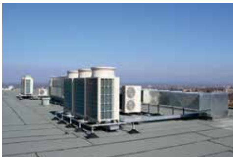
Die Technik über den Dächern von Paderborn.
