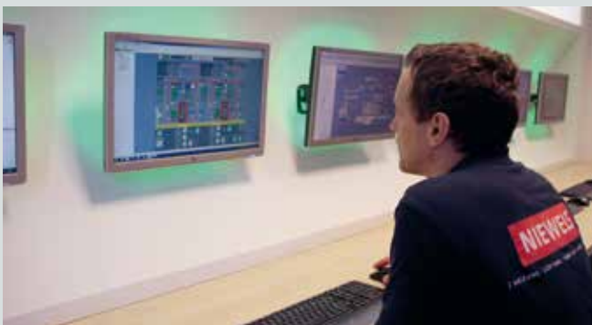
Niewels-Projektleiter Julian Barnick an der Gebäudeleitzentrale.
