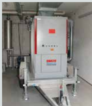
Mobiles BHKW, mit wenigen Handgriffen fahrbereit.
