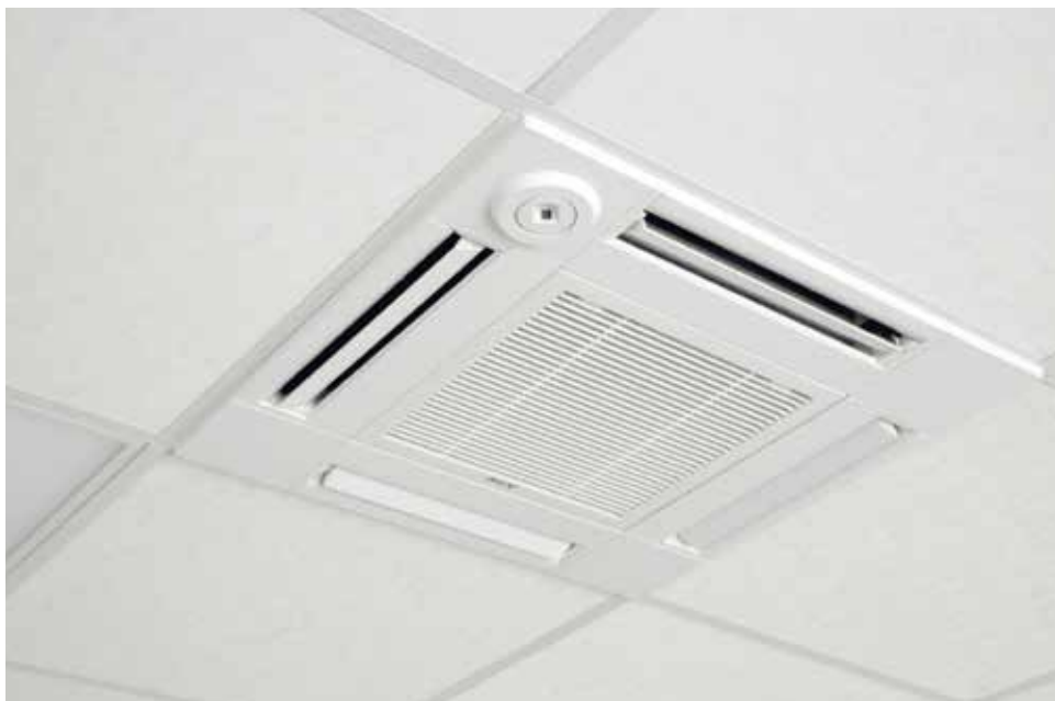
Deckenkassetten in den Büros mit Raumsensor.
