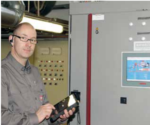
Starke Digitalisierung: NIEWELS-Service-techniker Mike Tewes vor einem BHKW.
