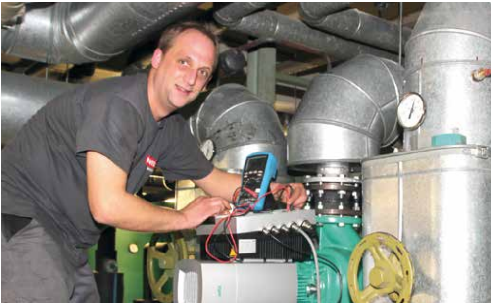
Kundendiensttechniker Daniel Wagner nimmt eine Pumpe Wilo Stratos GIGA in Betrieb.
