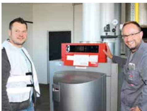
Euscher-Schichtleiter Michael Garn (r.) und NIEWELS-Projektleiter Olaf Striewe an der neuen Kesselanlage.
