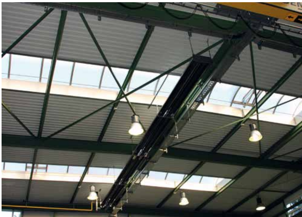
Die Euscher-Produktionshalle wird mit 10 U-Rohr-Strahlern bedarfsgerecht beheizt.
