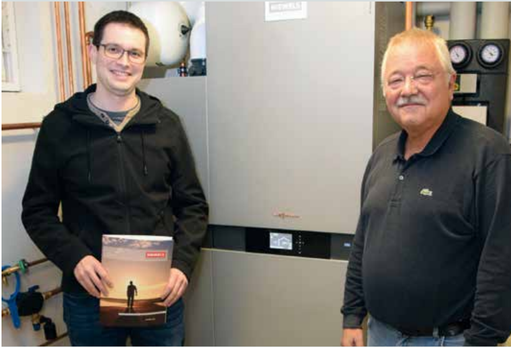
Klaus Mittelbach (r.) und NIEWELS-Projektleiter Thomas Heinemann an der Brennstoffzellen-Heizung.
